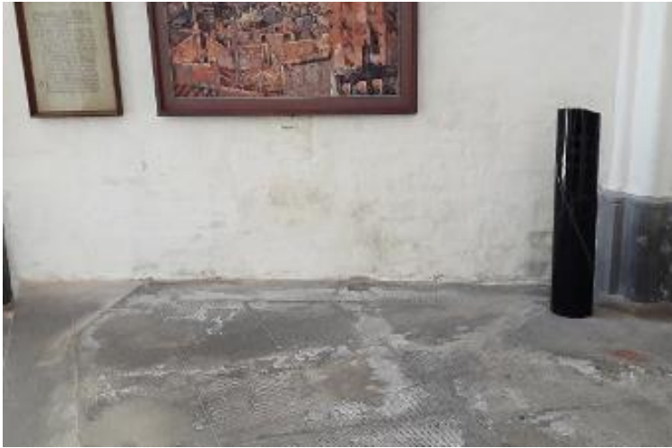
Abb. 12: Verschmutzungen durch Fußbodenheizung.
