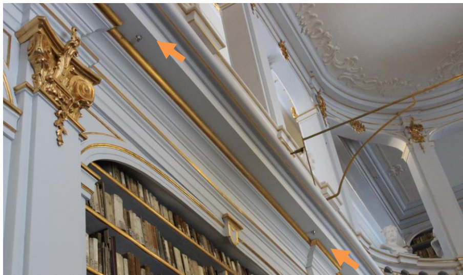
Abb. 8: Blick von unten auf die Sprühnebelanlagen (markiert mit orangenen Pfeilen) des neuen Brandschutzsystems im Rokokosaal
