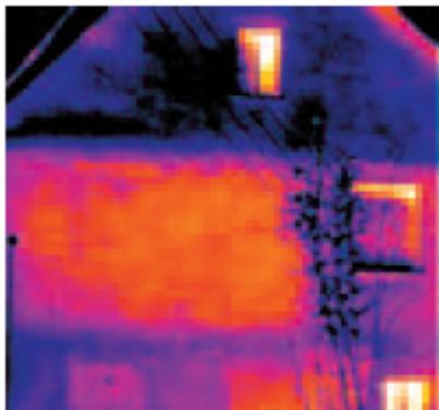
Schwachstellen an einer Hausfassade
