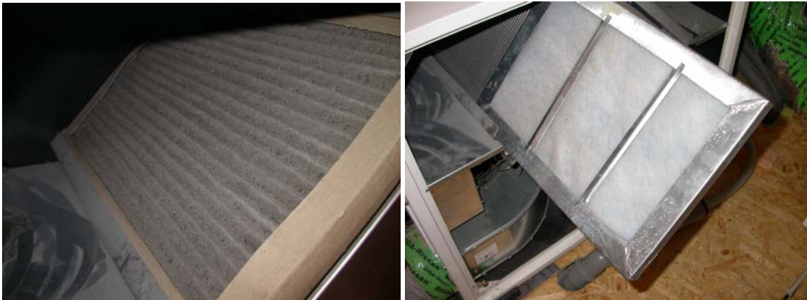
Abb. 1 + 2: Abluftfilter der Lüftungsanlage in Haus 1. Im linken Bild ist der 2 Jahre alte, vom Hersteller vorgesehene Filter zu sehen. Im rechten Bild ist der selbstgebaute Filterrahmen mit einer zugeschnittenen Filtermatte von der Rolle abgebildet.
