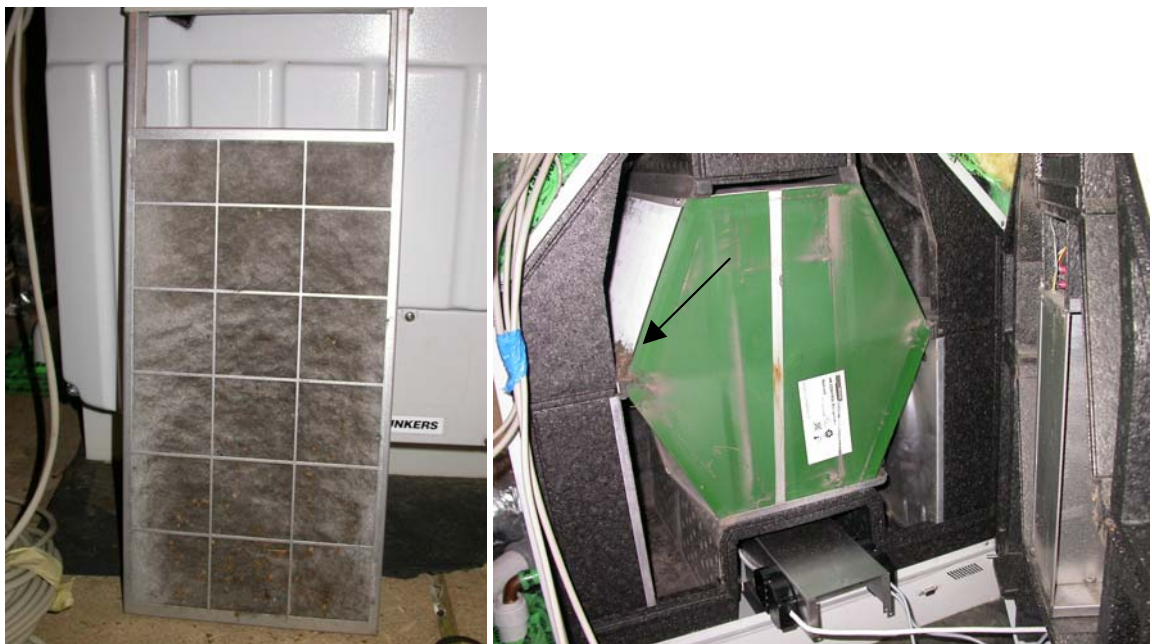
Abb. 4 + 5: Im linken Bild ist der Zuluftfilter nach ca. zweijähriger Standzeit und zweimaligem Waschen abgebildet. Rechts erkennt man innerhalb der Lüftungsanlage von Haus 2 die dichten Staubaablagerungen besonders im Zuluftbereich (s. Pfeil).
