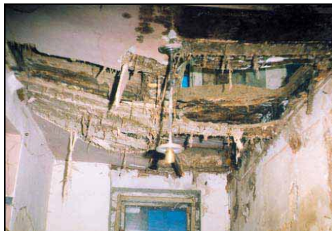
Zerstörung durch den Hausschwamm
