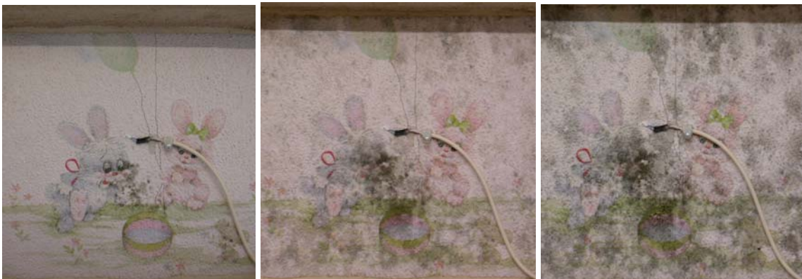
Abb. 9 bis 11: Die Testfläche „Tapete“ in Raum A am 13.10.04, am 11.11.04 und am 30.11.04 (von links nach rechts). Die Verkeimung der Fläche mit Schimmelpilzen nimmt mit der Zeit zu.
