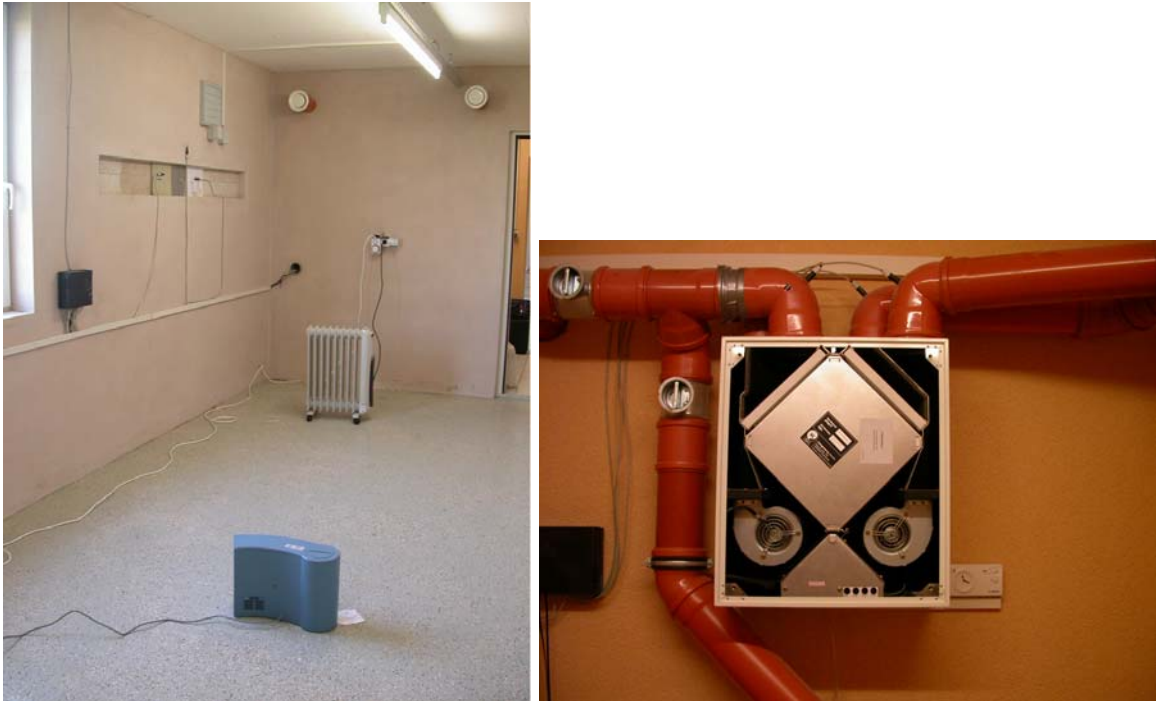
Abb. 3 + 4: Im linken Bild hat man einen Blick in den Prüfraum A, in dem die Fensterlüftung simuliert wird. Rechts ist die Lüftungsanlage mit Winterkassette und Filtern abgebildet, die sich im Messtechnikraum befindet (Bosch-Junkers LW120).
